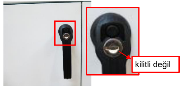
Resim 115: Kapı 'kapalı' ve 'kilitli' değil
