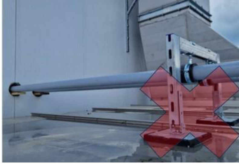
Resim 36: Uygunsuz boru hattı
