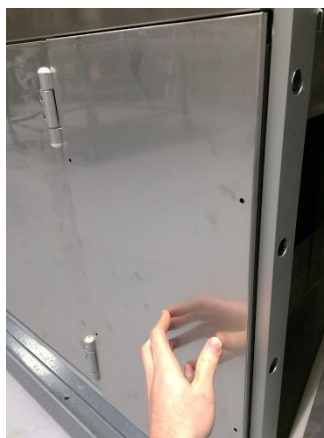
Figur 94: Ytterpanelen ej skruvad
