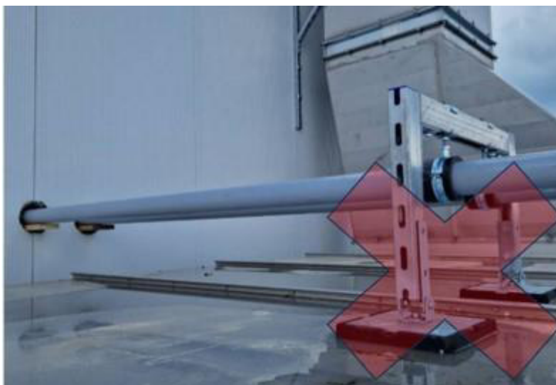
Рисунок 36: Неправильная прокладка трубопроводов на месте
