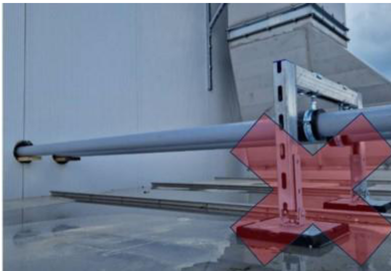
Figur 36: Feil rørføring på stedet
