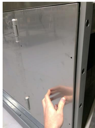
Figur 94: Det ytre panelet er ikke skrudd fast
