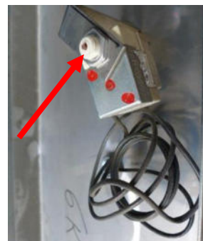
Afbeelding 195: Thermostaat met niet-afgesloten resetknop
