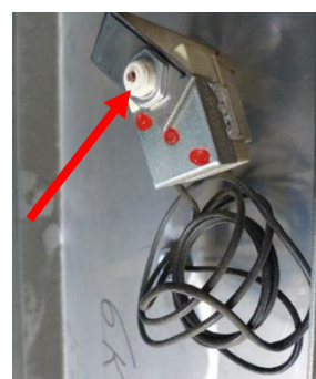
Afbeelding 82: Thermostaat met niet-afgesloten resetknop
