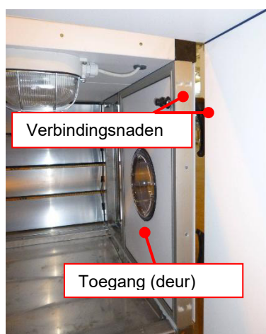
Afbeelding 41: Naden tussen apparaten toegankelijk via deur
