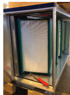
Slika 163: Odsek filtra z vstavljenimi filtri
