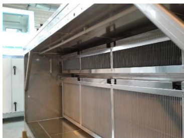
Slika 174: Elektrostaticni filtri v okvirju filtra
