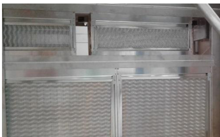
173. ábra: Elektrosztatikus szűrő felszerelése
