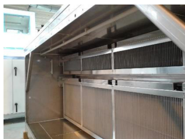
Kuva 167: Sähköstaattiset suodattimet suodatinkehyyksessä
