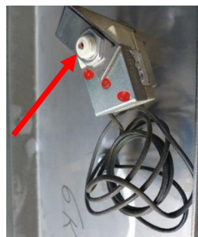
Kuva 210: Termostaatti, jonka palautuspainike on suojaamaton
