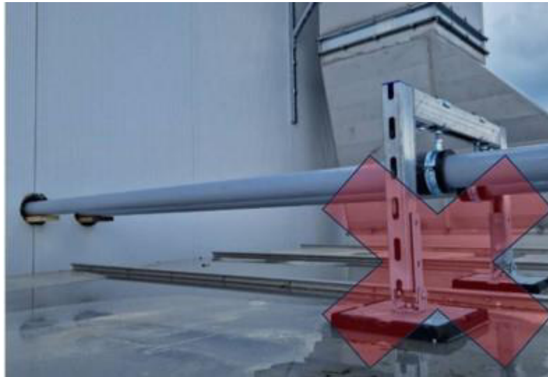
Kuva 36: Virheellinen putkisto paikan päällä
