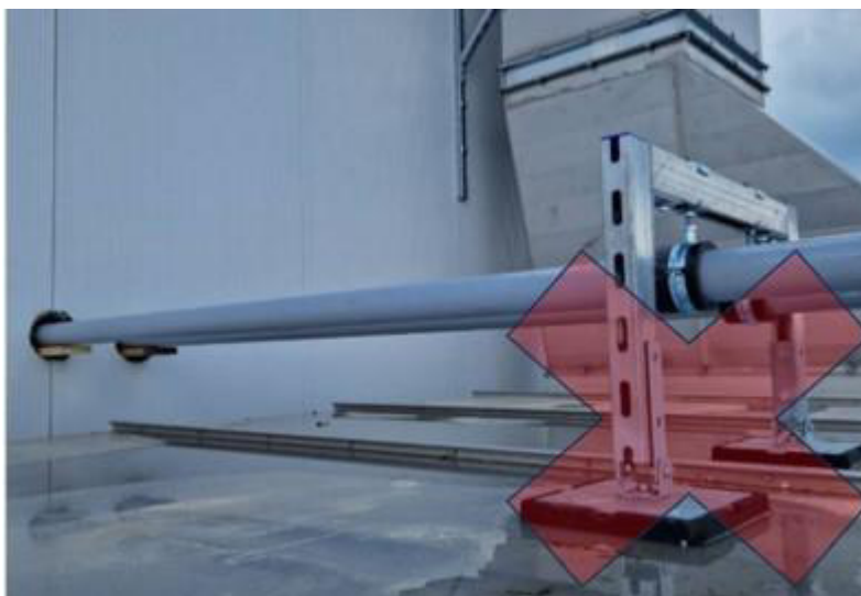
Fig. 36: Forkert rørføring på stedet
