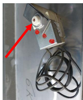
Fig. 207: Termostat med nulstillingsknap uden dæksel
