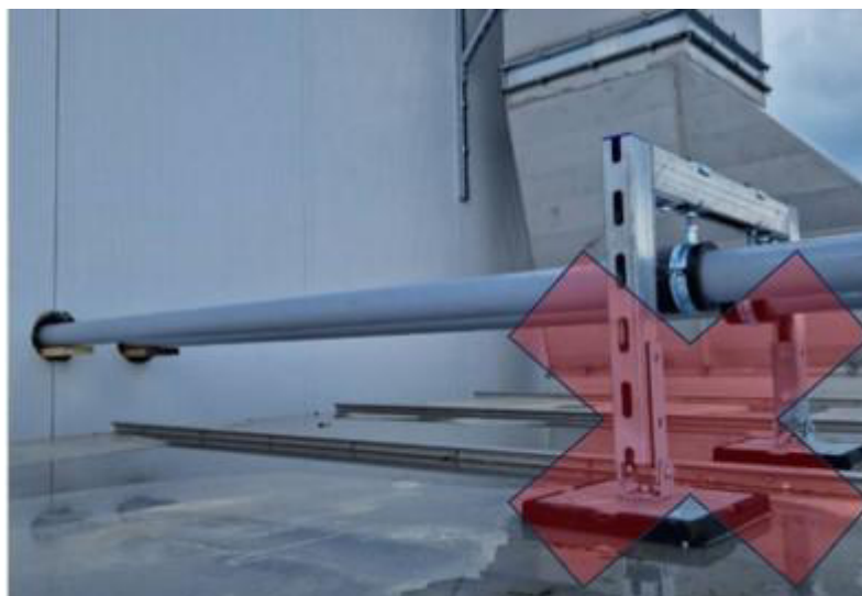
Abbildung 21: Unzulässige bauseitige Verrohrung
