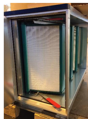
Abbildung 57: Filtersektion mit eingeschobenen Filtern
