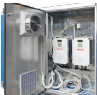
Control device Schaltschrank Pannello di controllo
